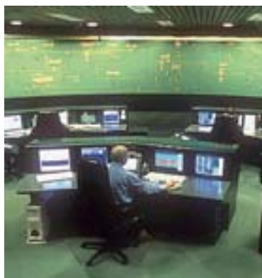
Il centro di controllo della rete Snam
